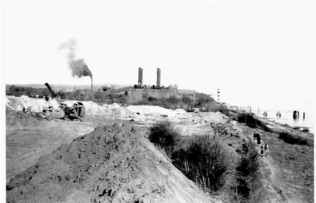
Baubeginn, Frühjahr 1954. Im Hintergrund das alte Kraftwerk Schulau und der Leuchtturm neben dem Hafen der Mobil Oil. Der stark rauchende Schornstein gehört ebenfalls zur Mobil Oil. Quelle: Stadtarchiv Wedel
